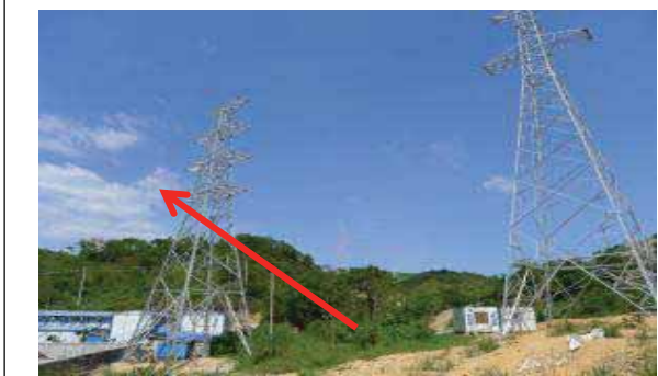
110kV 涌仔站接线方向
