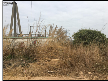
热电厂东侧九潭变电站
